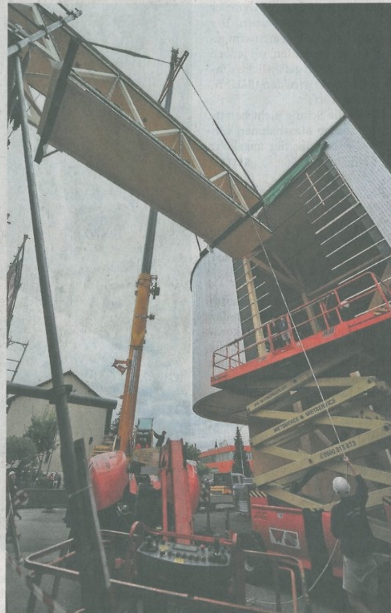
Brückenschlag in luftiger Höhe: Der Spezialkran, dirigiert von mehreren Helfern, setzt die Passerelle ein.
